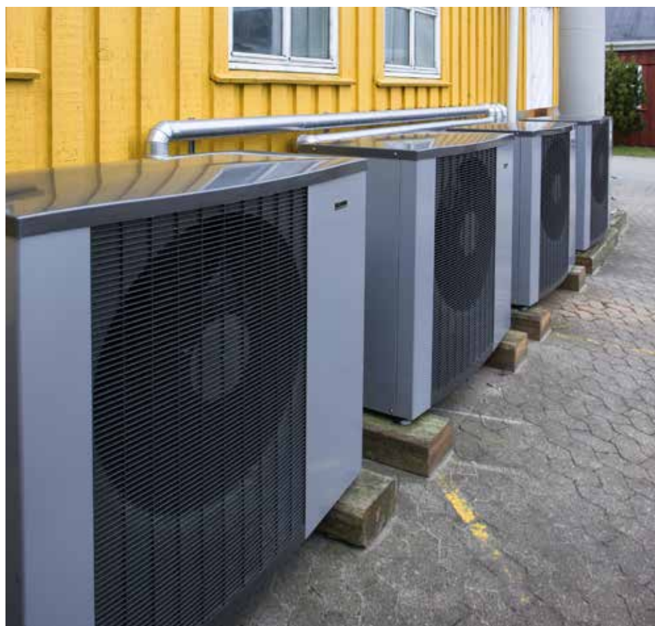
Kaløvig Bådelaug fik installeret 4 F2120 luft/vand varmepumper som afløsning for det gamle oliefyr. Den miljøvenlige løsning har givet en årlig besparelse på 145.000 kr.
